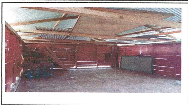
Foto 2: TECHO EXTERIOR EN MAL ESTADO MODULO 5
